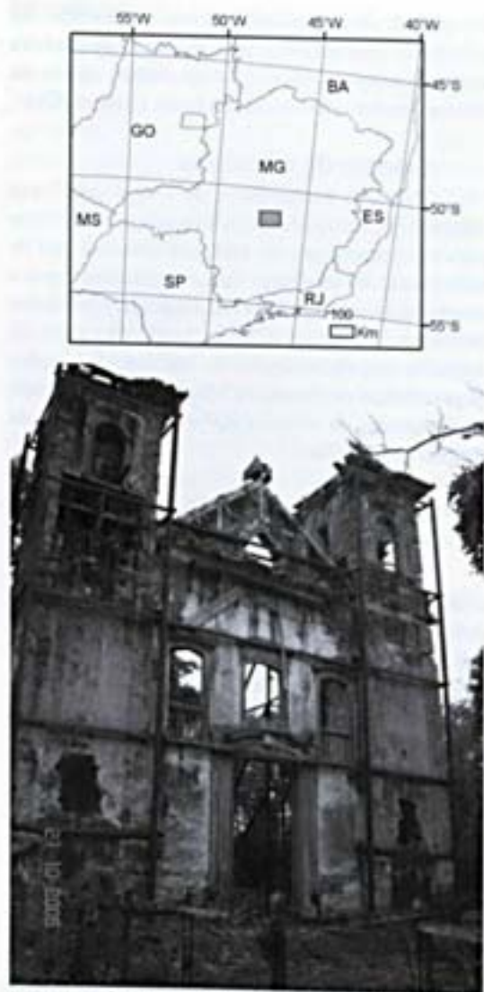
Figura 1 – Área de estudo – a. localização do município de Matuzinhos; b. vista frontal da igreja Nossa Senhora da Conceição evidenciando aspectos arquiteturais e de conservação da igreja.
